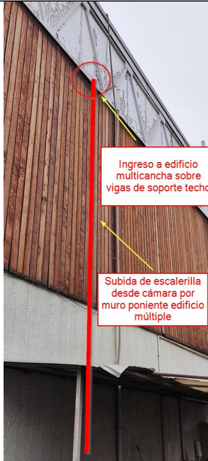
figura 7: subida canalización alimentadores sobre edificio multi cancha
